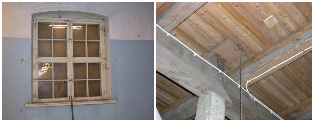
Fönster i rum 4, i de östra delarna förekommer blå väggfärg medan de östra delarna av byggnaden är grön. T.h ventil i mellanbjälklaget.
